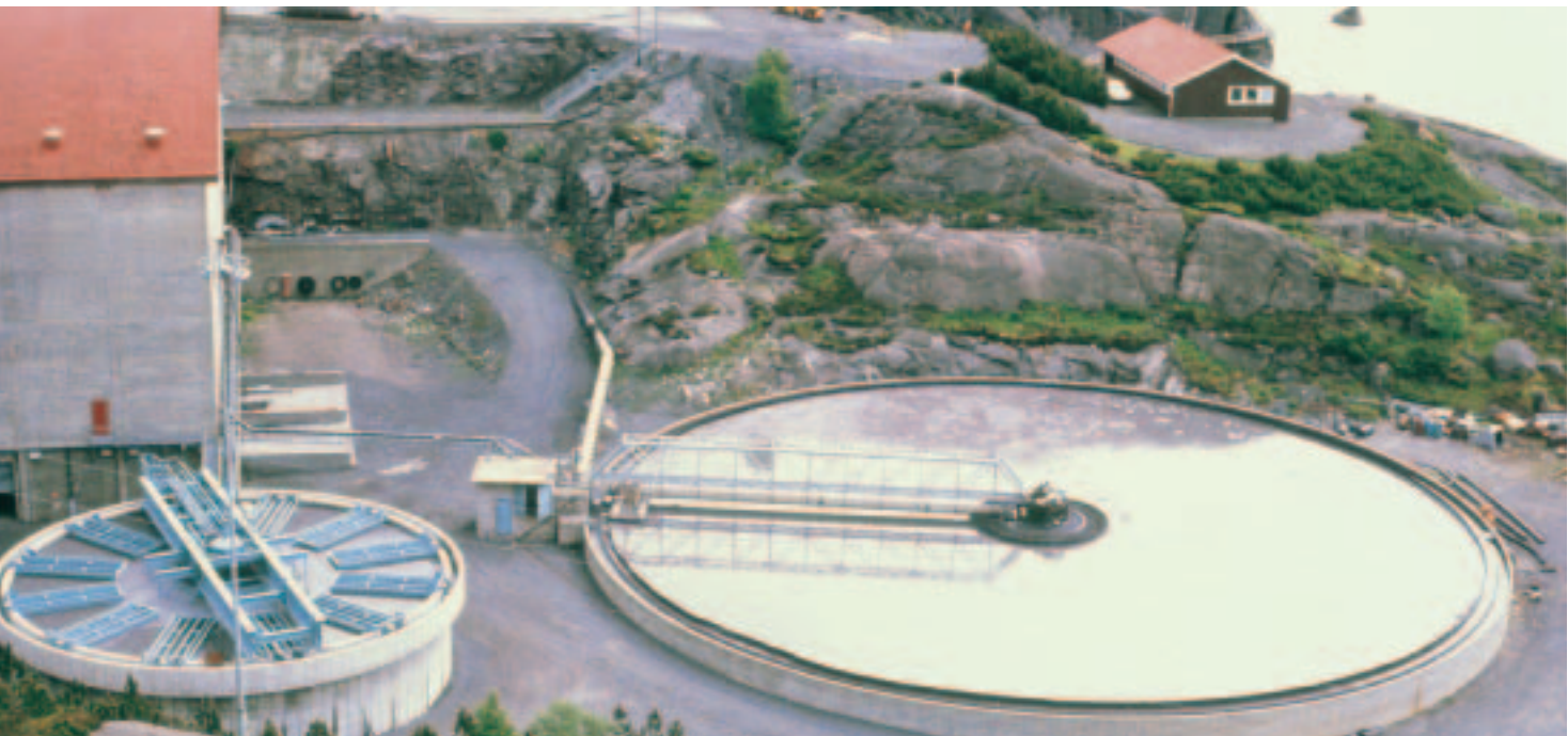
Installation eines Svedala LTC Combi-Lamellenklärers neben einem konventionellen Rundeindicker mit ungefähr identischem Klärungsflächenbereich.
